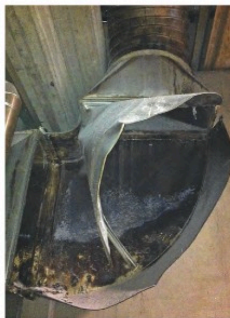
Il danno provocato da una curva esplosa in una cartiera.
