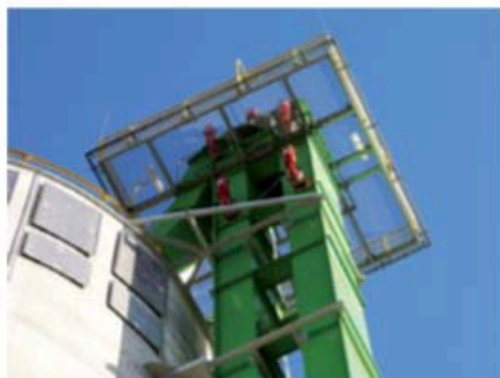
Sistema di protezione per esplosione da polveri su un elevatore a tazze (Erigo).
